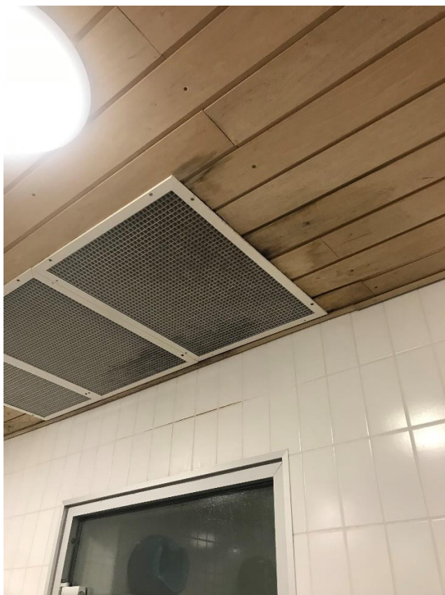
Naisten pesuhuoneen katossa näkyvät kosteusvauriot
